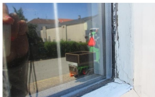
Vindue i dårlig stand
