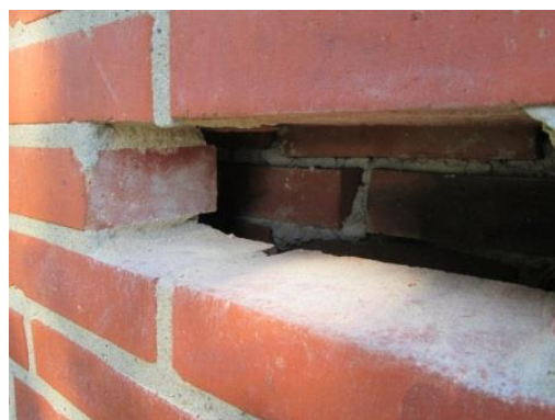
Ingen isolering i hulmur
