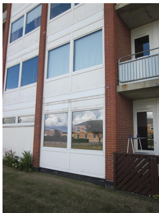
Lukkede felter ved vinduespartierne
